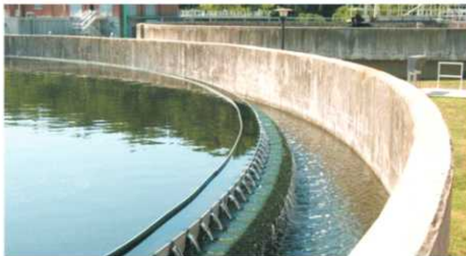
चित्र 18.5 जल शुद्धीकरण टंकी (Water Clarifier)
